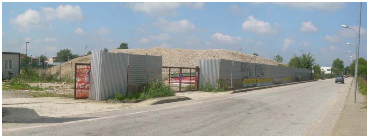
Foto 5.1/I – Vista di Via Sassi in direzione di Via Fratelli Cervi. Sulla sinistra sono evidenti i cumuli di materiale inerte derivanti dagli scavi dell'area ex Elbi
