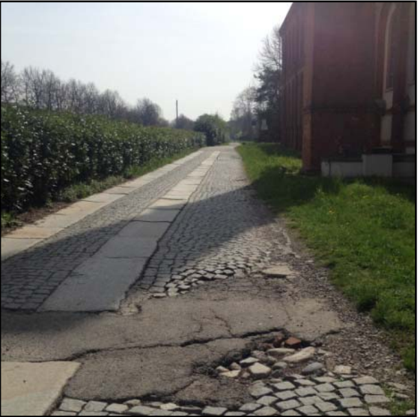
Foto della pavimentazione danneggiata (Lavanderia a Vapore)
